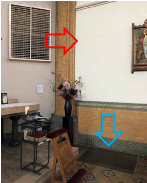
Het inblaas- en retourrooster in de Groenestraatkerk in Nijmegen liggen dicht bij elkaar waardoor het risico op 'kortsluiting' ontstaat; het staat een goede warmteverdeling in de weg.
