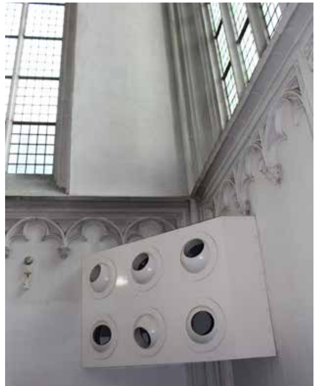
Een luchtinblaas-unit met nozzles voor een betere warmteverdeling in de Stevenskerk in Nijmegen
