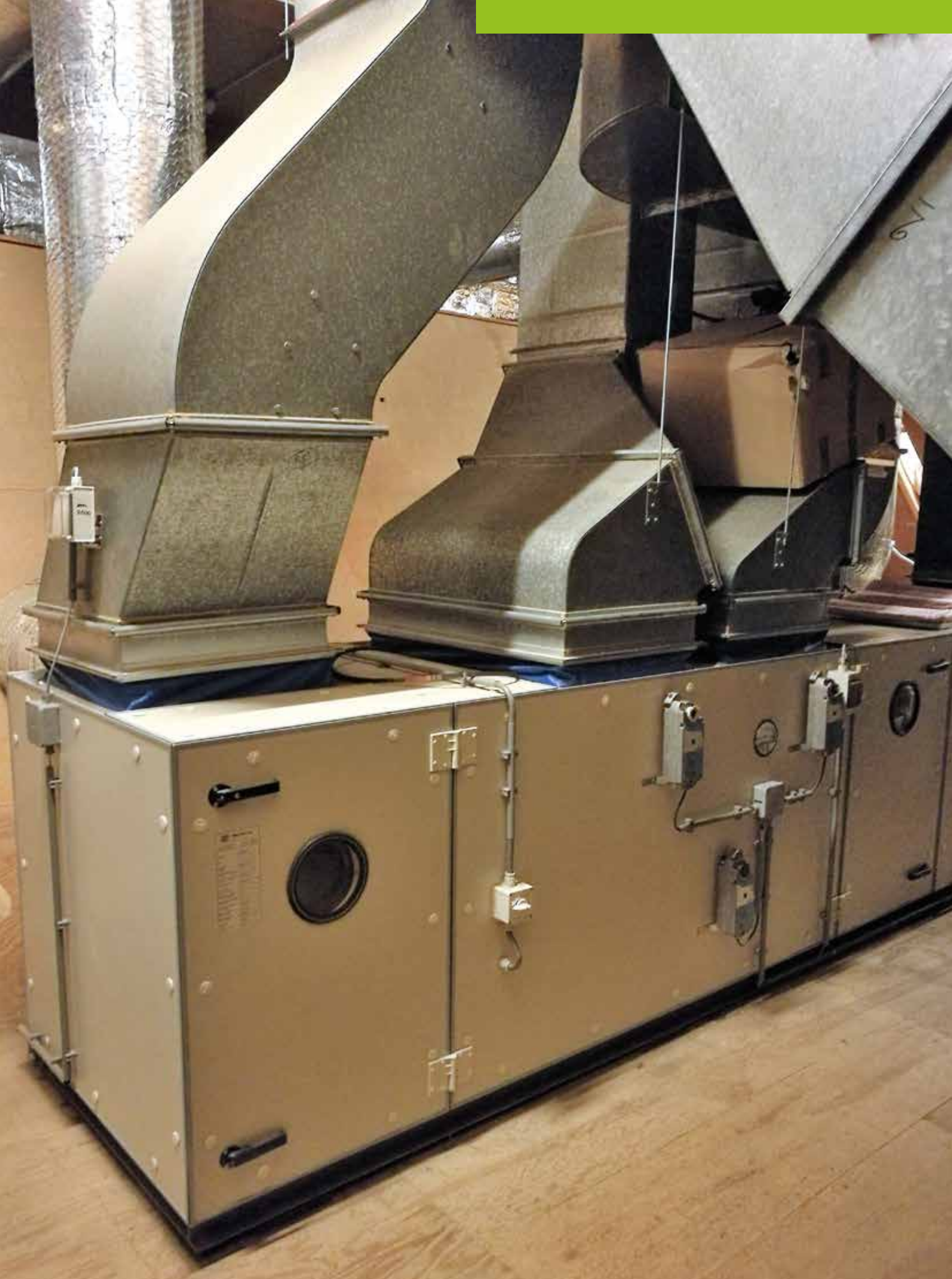
Luchtbehandelingsinstallaties die zijn gekoppeld aan een Gebouw Beheers Systeem
