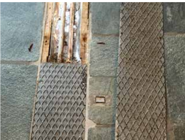
Voetverwarming in de Remonstrantse Kerk in Nijmegen, bestaande uit een tranenplaat met daaronder de verwarmingsleiding. Door het ontbreken van contact tussen de verwarmingsbuizen en de platen is de warmtegeleiding beperkt en werkt de voetverwarming niet goed. Als oplossing kunnen de buizen worden uitgerust met metalen geleiders (strips) om het warmtetransport naar de tranenplaat te verhogen.
