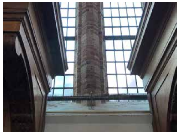
Voorbeeld verwarmingselement onder een kerkraam
