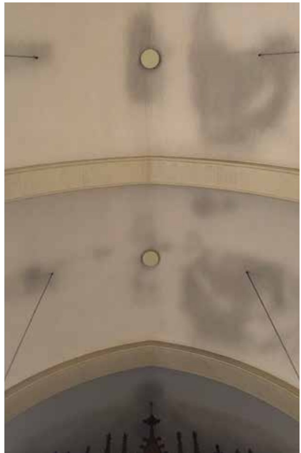
Voorbeeld van gewelven waarbij condensatieproblemen ontstonden als gevolg van plaatselijk uitgezakte isolatie.
